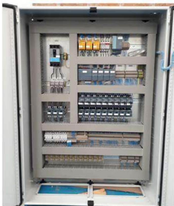
Figura 10.15. Imagen ilustrativa de Tablero de Control y Fuerza.
